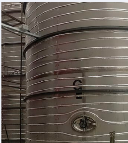
Technologický ohřev kapaliny, Rumunsko
